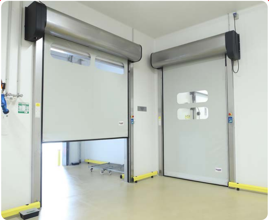
Cámaras frigoríficas y puertas
